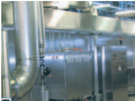
Sistema di riscaldamento
